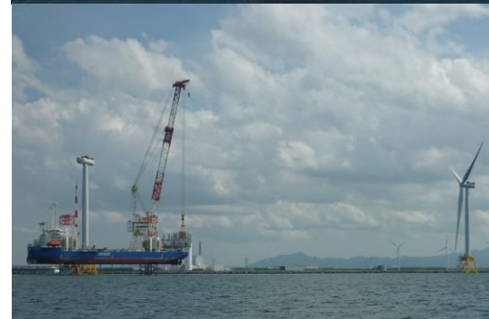
(株)グリーンパワーインベストメント(GPI)による石狩湾新港洋上風力発電所建設作業の様子
